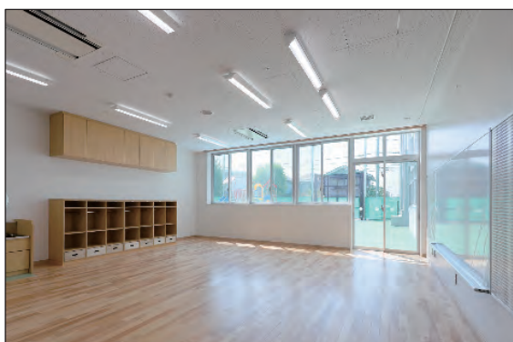
【都立特別支援学校においてLED照明を整備した普通教室の例】
