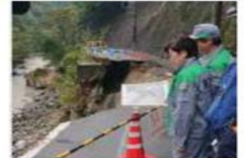
台風により被害を受けた都道204号線(2019年10月15日)
