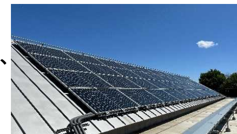
都立学校屋上の太陽光発電設備
